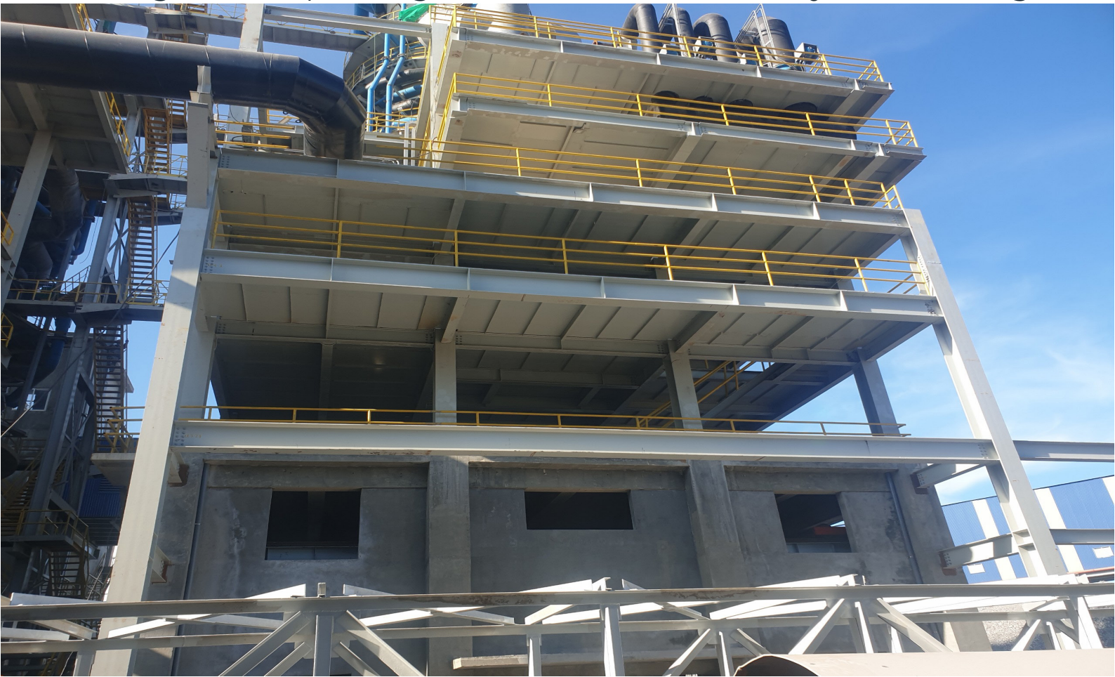
Công trình Hệ thống lò DOLOMIT - Nhà máy vôi xi măng
